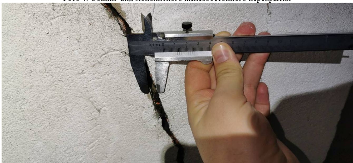
Фото 5. Общий вид замеров ширины раскрытия трещины штангенциркулем
