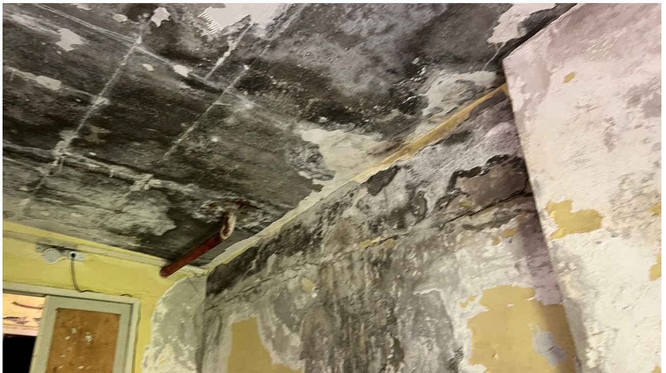
Фото №4. Помещение паркинга, множественные протечки.
