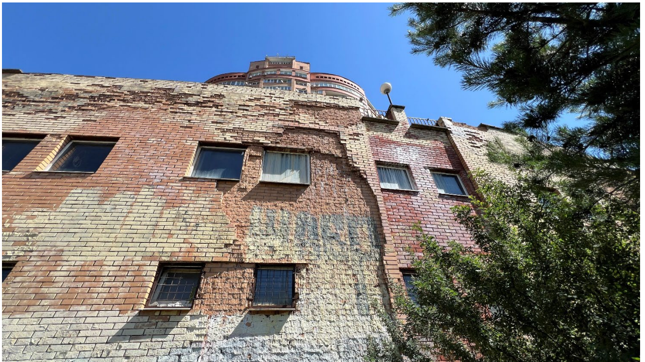
Фото №6. Фрагмент фасада, состояние кладки кирпича наружной стены.
