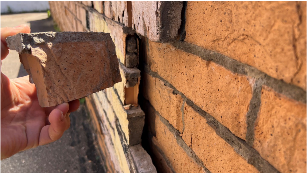
Фото №8. Разрушение лицевой поверхности кирпича.
