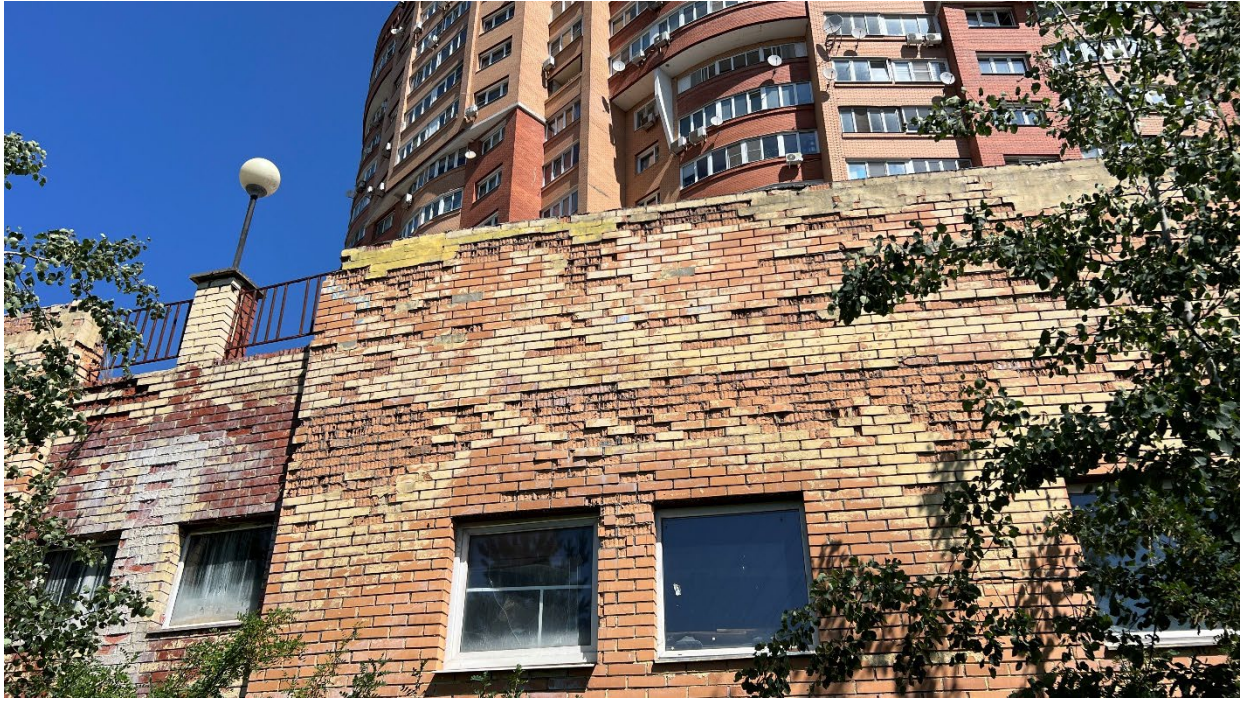
Фото №7. Фрагмент фасада, состояние кладки кирпича наружной стены.
