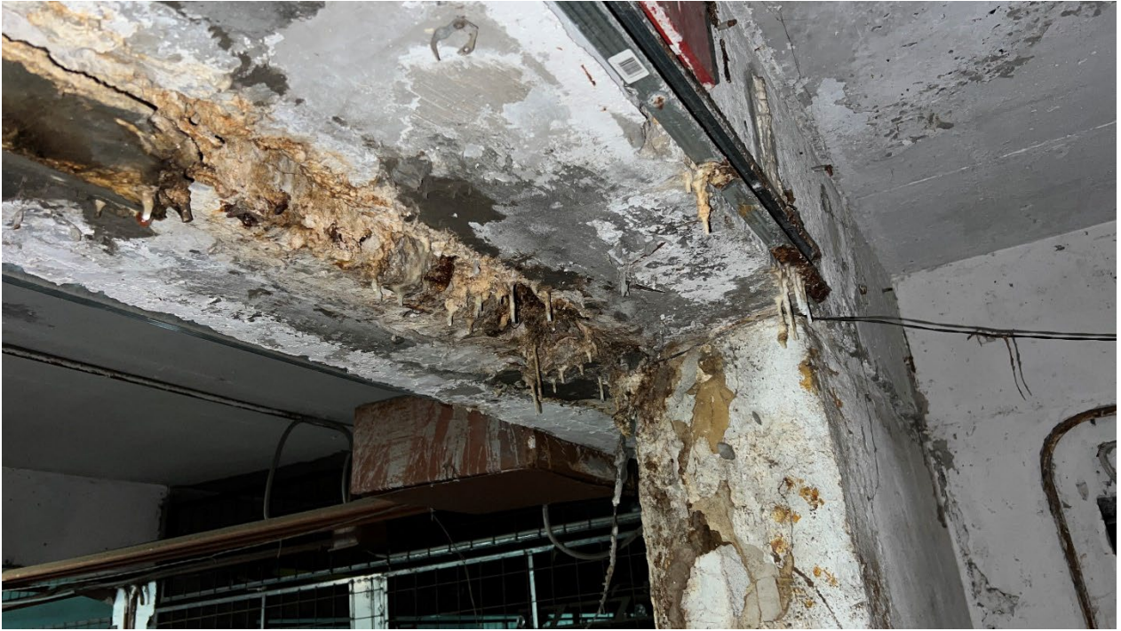
Фото №5. Помещение паркинга, следы протечек, обрушение отделочных слоев.
