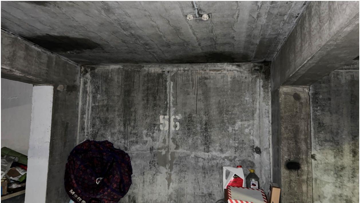
Фото №3. Наружная стена, следы протечек.
