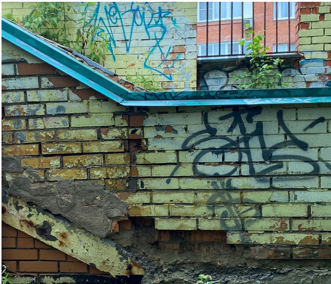
Фото №12. Состояние кирпичного ограждения лестниц.
